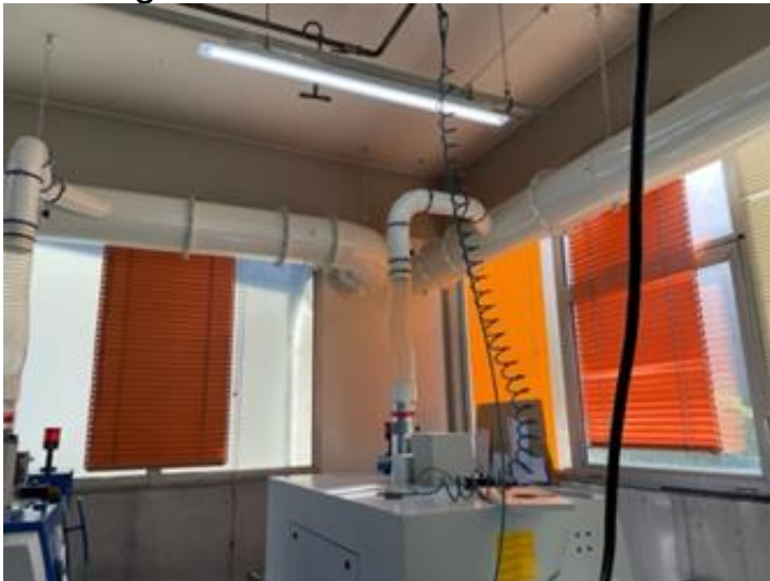
captage des brouillards d'huile - photo TIMS
